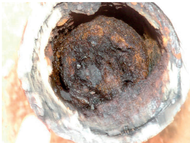
Фото 3.1. Закупорка проходного сечения нефтепромыслового трубопровода АСПО 7
